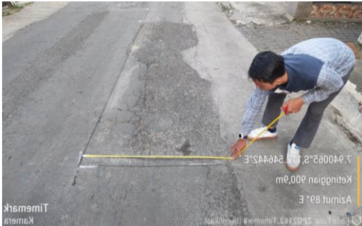
Gambar 6. Peninjauan kerusakan jalan secara langsung
