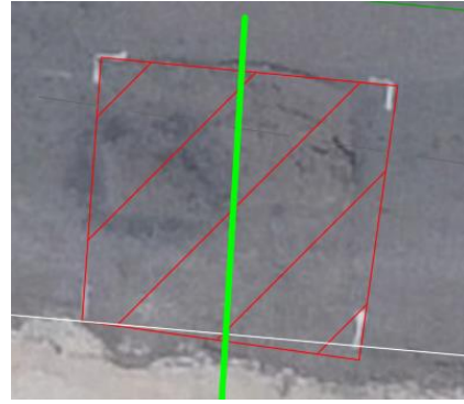
Gambar 7. Tampak Atas kerusakan jalan jenis amblas ( depresi )
