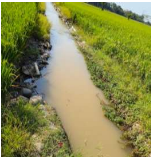
Gambar 1. Contoh kerusakan saluran pada D.I Comal
