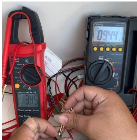
Gambar 6 : Pengujian Panel Surya
