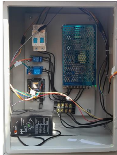
Gambar 17: Instalasi Rangkaian Kelistrikan dan IoT
