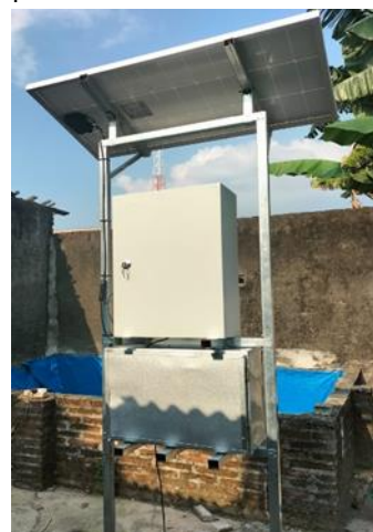
GAMBAR 3.1 REALISASI PEMBANGKIT LISTRIK TENAGA SURYA
