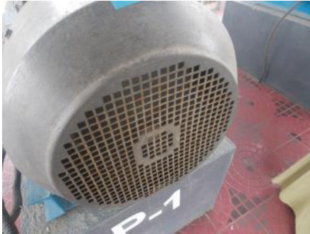
Gambar 4.10 Kondisi tutup pelindung kipas P1 cukup baik
