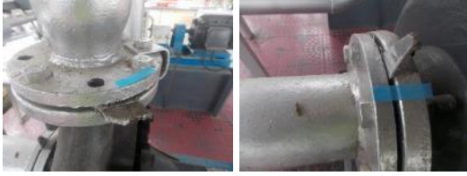
Gambar 4.8 Terdapat ganjalan pada sambungan pipa pompa P1
