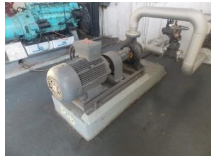
Gambar 1 Kondisi fisik motor pompa P6 yang berdekatan dengan genset
