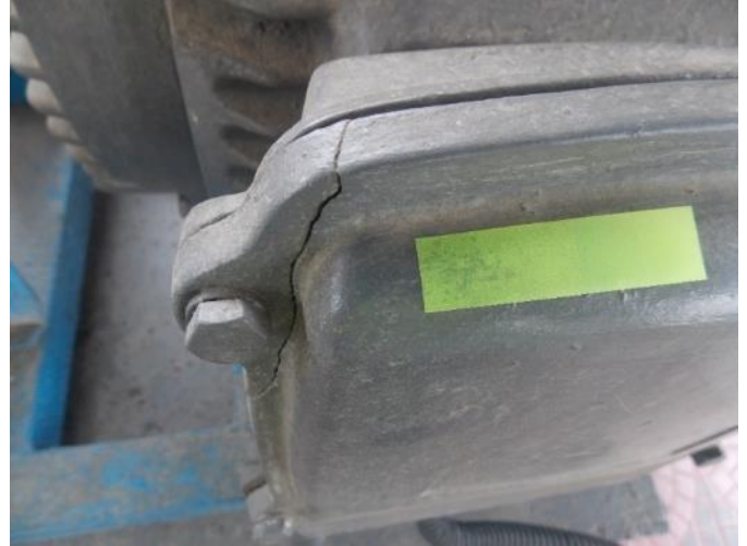
Gambar 4.12 Terdapat keretakan pada tutup terminal box P3
