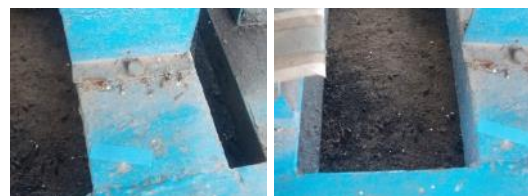
Gambar 4.7 Kondisi motor pompa P1 yang kurang bersih
