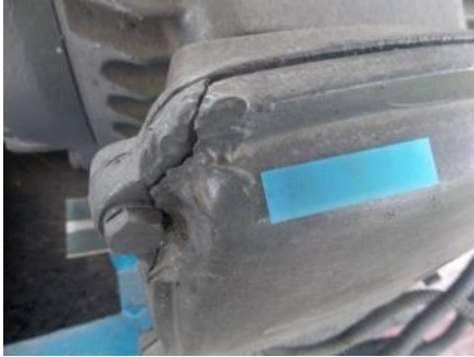
Gambar 4.9 Terdapat keretakan pada tutup terminal box P1
