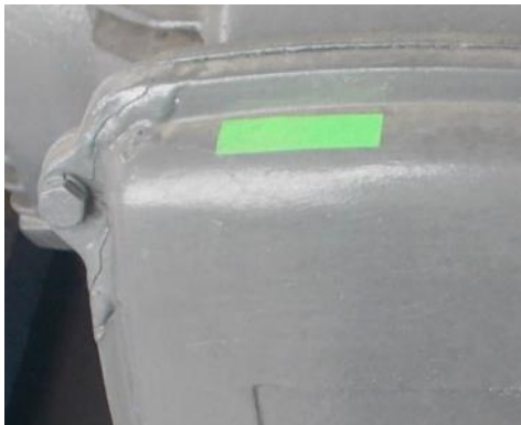
Gambar 4.11 Terdapat keretakan pada tutup terminal box P2
