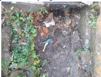
Gambar 2. Kondisi Saluran Eksisting
