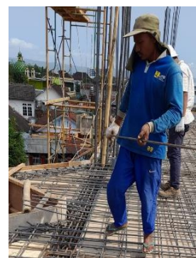
Gambar 2. Pekerja tidak menggunakan APD
