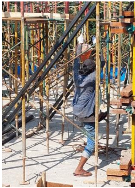
Gambar 3. Pekerja tidak menggunakan APD
