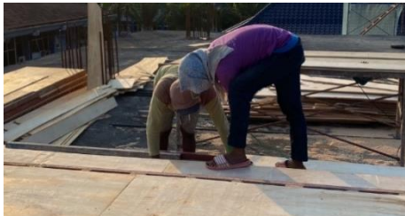
Gambar 4. Pekerja tidak menggunakan APD
