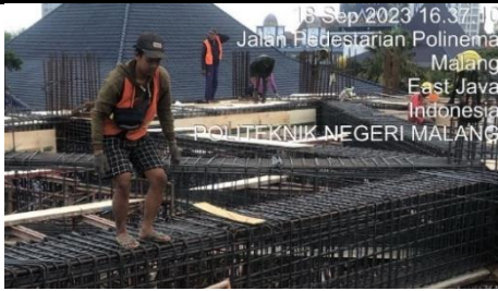
Gambar 3. Pekerja tidak menggunakan APD
