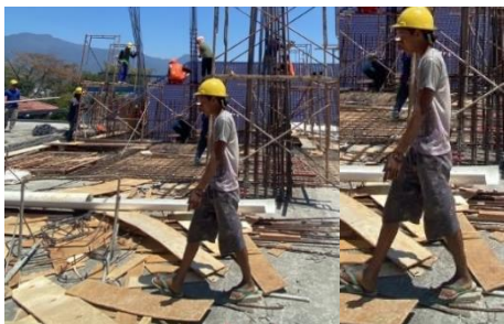
Gambar 6. Pekerja hanya menggunakan helm
