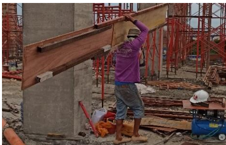
Gambar 5. Pekerja hanya menggunakan sepatu
