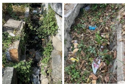
Gambar 1. Saluran drainase di atas permukaan
