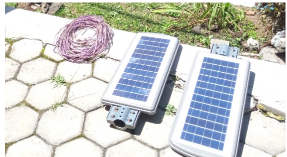
Gambar 4. Lampu PJU Berbasis Panel surya dan PIR
