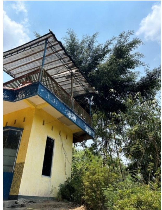
Gambar 7. Posisi Pemasangan Perangkat
