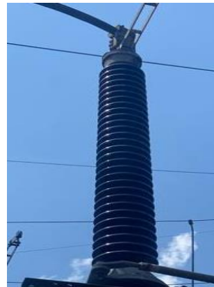
Gambar 2 Isolator PMS (Sumber: Gardu Induk Sutami)
