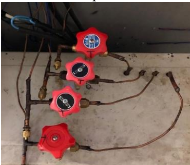
Gambar 4. Kondisi kran terbuka 0,25 bukaan
