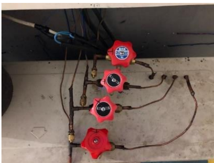
Gambar 5. Kondisi kran terbuka 1 bukaan
