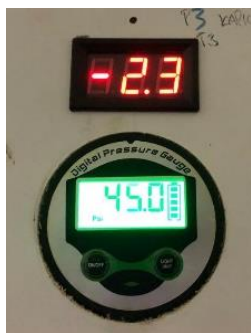
Gambar 8. Panel pengukuran suhu dan tekanan refrigeran
