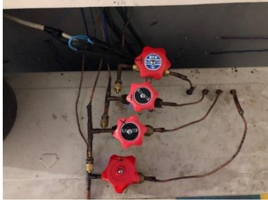
Gambar 3. Kondisi kran saat tertutup sempurna
