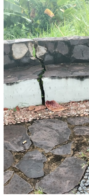
Gambar 12. Retakan di depan benteng
