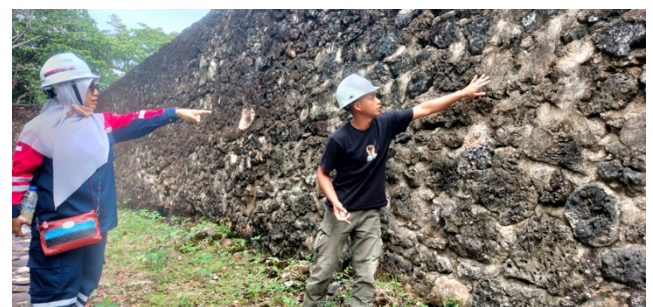
Gambar 8. Pengecekan titik retakan
